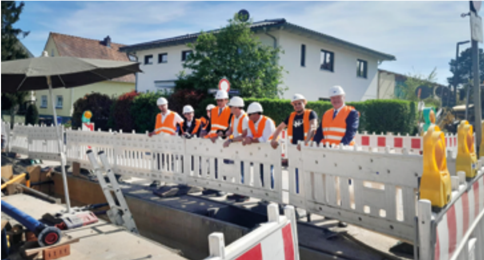
Auf Baustellenbesuch in Bad Homburg: Hessens Finanzminister Boddenberg (5. v. r.) und Präsident der IHK Frankfurt/Main Caspar (rechts) mit Schuchmann-Geschäftsführer Voß (3. v. r.) und einigen Mitarbeiterinnen und Mitarbeitern. (Foto: IHK Frankfurt)
