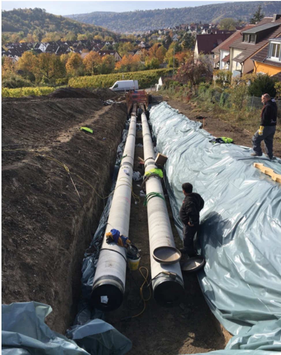
Blick auf die Wasserleitungen DN 500 (ND) und DN 700 (HD) vom Hochbehälter Goldberg. (Fotos: Martin Weitbrecht Rohrleitungsbau GmbH)
