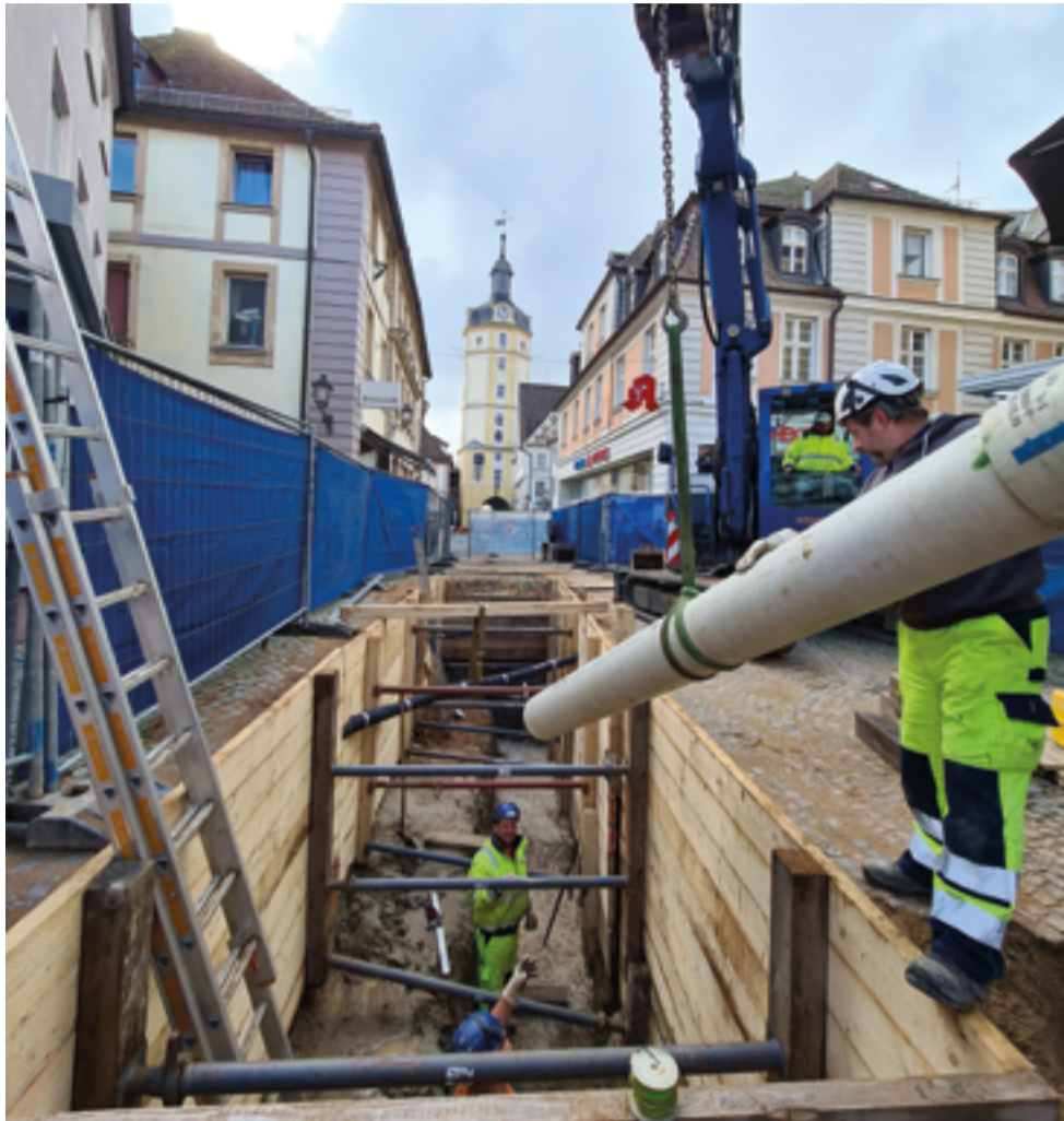
Ein GFK-Rohr wird in den Rohrgraben in Ansbach eingebracht. Um die Bausubstanz der umliegenden Gebäude zu schützen, hat die Karl Krumpholz Rohrbau GmbH einen waagerechten Holzverbau nach DIN 4124 hergestellt. (Fotos: Karl Krumpholz Rohrbau GmbH)
