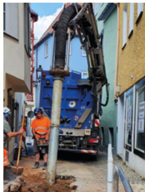
Der Saugbagger macht ein erschütterungsfreies Ausheben der Baugrube möglich. Auch angesichts der engen Platzverhältnisse in der Innenstadt ist er eine gute Wahl.
