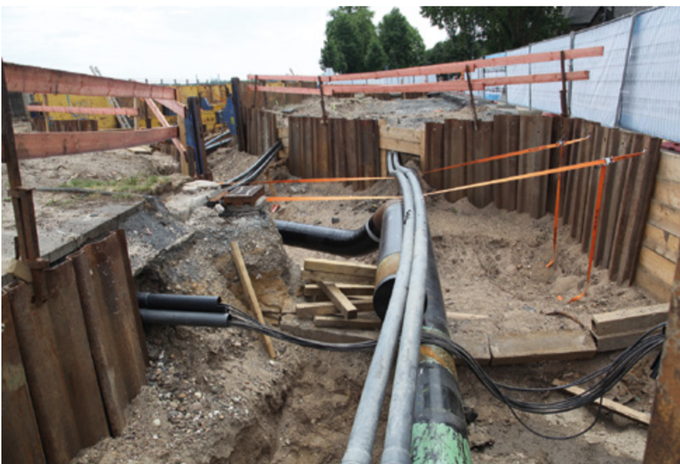
Die alte Gashochdruckleitung DN 400 quert den geplanten Zielschacht und muss daher umgelegt werden. Noch ist die neue Leitung im Bild nicht eingebunden. (Foto: rbv)
