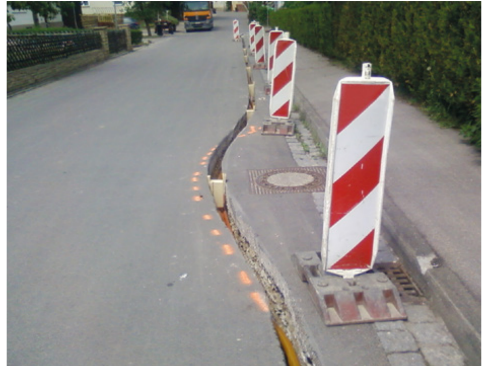
Wer billig baut, baut zweimal: Auch schnell und unsachgemäß eingezogene Glasfaserleitungen müssen schon nach kurzer Zeit erneuert werden. Diese Kosten trägt genauso die Allgemeinheit wie die Aufwendungen für die Erneuerung der Straßenoberfläche. (Foto: Dieter Schaffaff)
