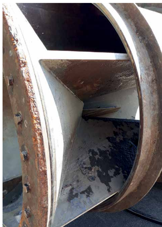
An dem Schieberrohr sind im Auslassbereich die Kavitationsschäden gut zu erkennen. (Foto: CTR)
