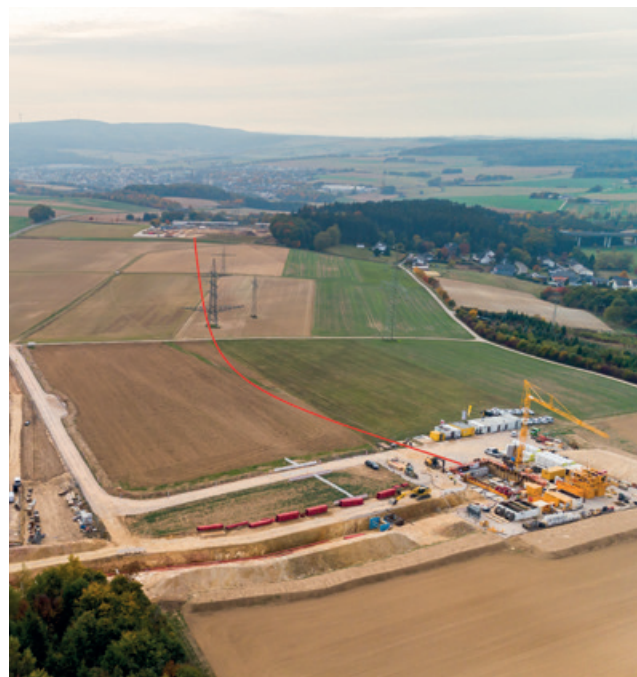
Trassenverlauf von der Umspannanlage Bacharach zur Anlage Rheinböllen.
