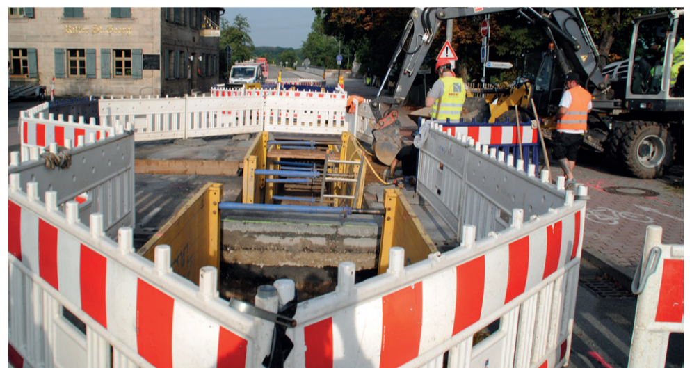
Der zweite Bauabschnitt „Talquerung Herzogenaauracher Damm“ erfolgte im August 2019 mittels HDD-Verfahren. Zur Einrichtung der Startgrube und zur Anbindung der Leitung in der Äußeren Brucker Straße an das Netz wurde es notwendig, die Verbindungsstraße über die Regnitz in Richtung Herzogenaaurach zwischen dem 29. Juli und dem 9. September 2019 komplett zu sperren.
