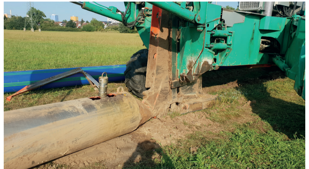
Während das klassische Pflugverfahren für die Verlegung von Rohren bis rund DN 250 ausgelegt ist, ermöglichte eine Erweiterung des Pflugs um eine Torpedokonstruktion mit Verdrängerteil auch die Verlegung größer dimensionierter Rohre.
