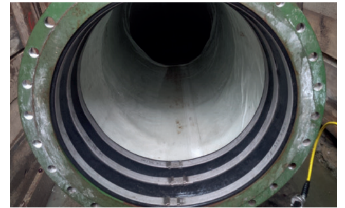
Endmanschette bei einer mittels vor Ort härtenden Schlauch-Lining sanierten Druckrohrleitung. (Foto: Berliner Wasserbetriebe)
