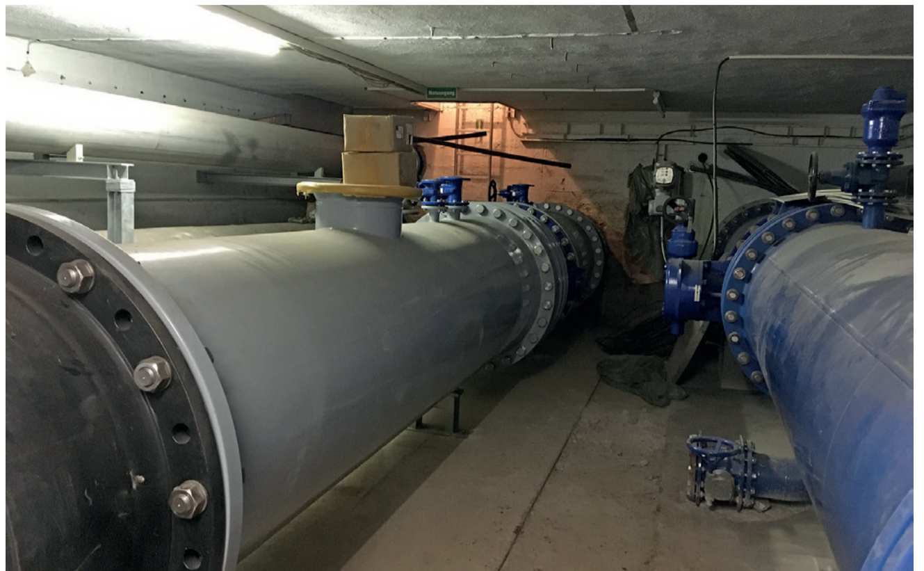
Durch die Inbetriebnahme der zusätzlichen Leitung wird die Bestandsleitung entlastet. Die Förderleistung bleibt insgesamt gleich.
