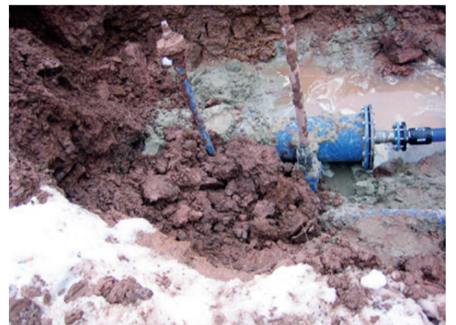
Der Graben ist durch Witterungseinflüsse teilweise eingestürzt.
