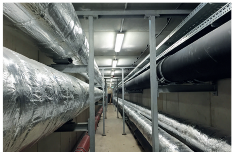
Die Umverlegung des Medienkanals, der ein Ringleitungssystem für die Wärme-, Kälte- und Stromversorgung sowie das Wasser- und Abwassersystem und die Datenleitungen des gesamten Campus darstellt, wurde durch den Neubau eines Fakultätsgebäudes notwendig.
