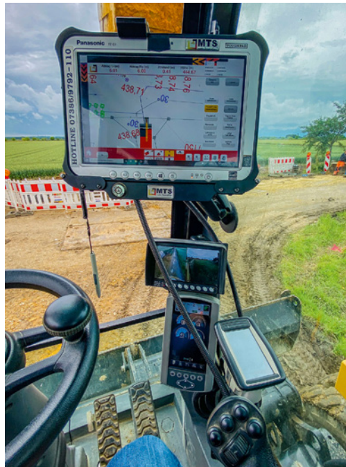
Abb. 1 (links): Das Tablet zeigt dem Baggerfahrer alle digitalen Daten an, die für die Baumaßnahme erforderlich sind. Dadurch entfällt das Handaufmaß.
