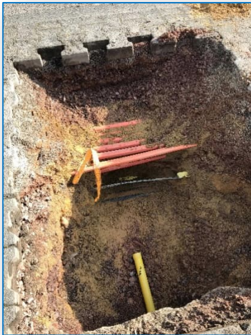
Überbauung von Versorgungsleitungen durch Breitband / © Westnetz GmbH
