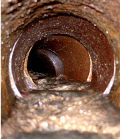
Defekte Anschlüsse sind ein Dauerproblem in deutschen Abwassernetzen.
