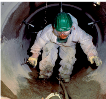
Der logische Schlusspunkt der Eigenkontrollvorschriften: Sanierung defekter Kanäle und Bauwerke.
